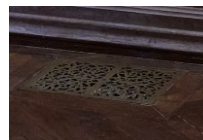
Grille de sortie du calorifère dans le bureau de l'Empereur
